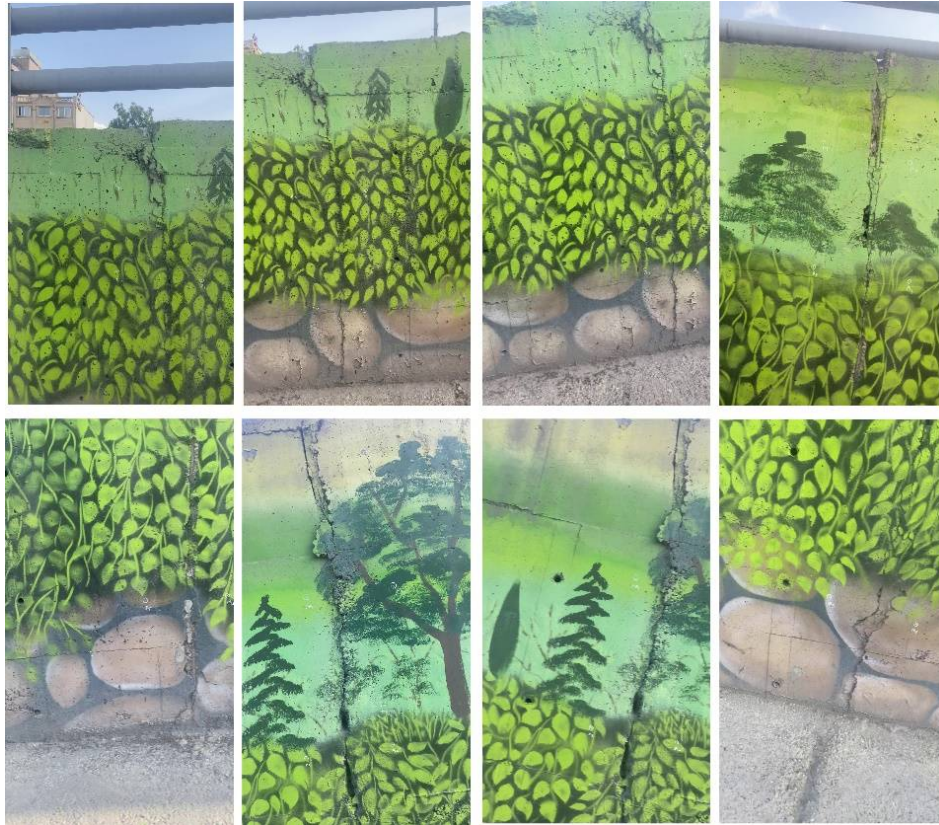
شکل ۷- نمونه‌ای از تصاویر شناسایی شده حاوی ترک از دیواره پل
